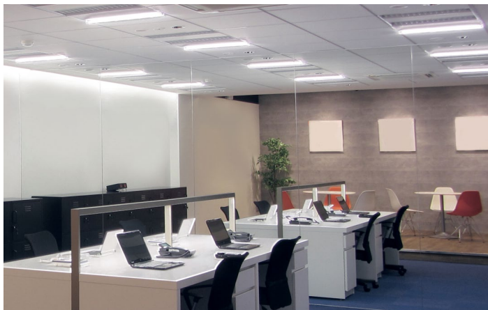
(LEDの設置事例)
